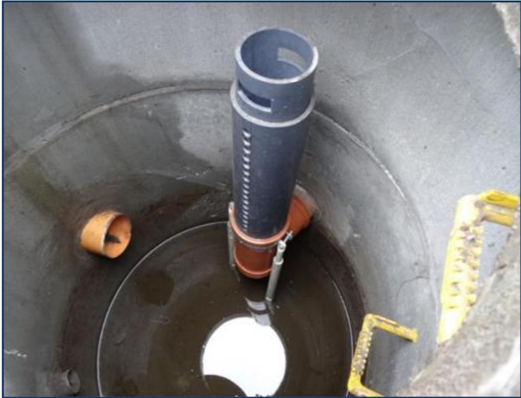
Rycina 4 Regulator obrotowy w studziencie na obiekcie drenarskim Kolonia Bodzanowska (woj. kujawsko-pomorskie). Projekt INOMEL, autorzy projektu urządzenia: M. Sojka, R. Stasik, M. Napierała, R. Wróżyński (UP Poznań)
