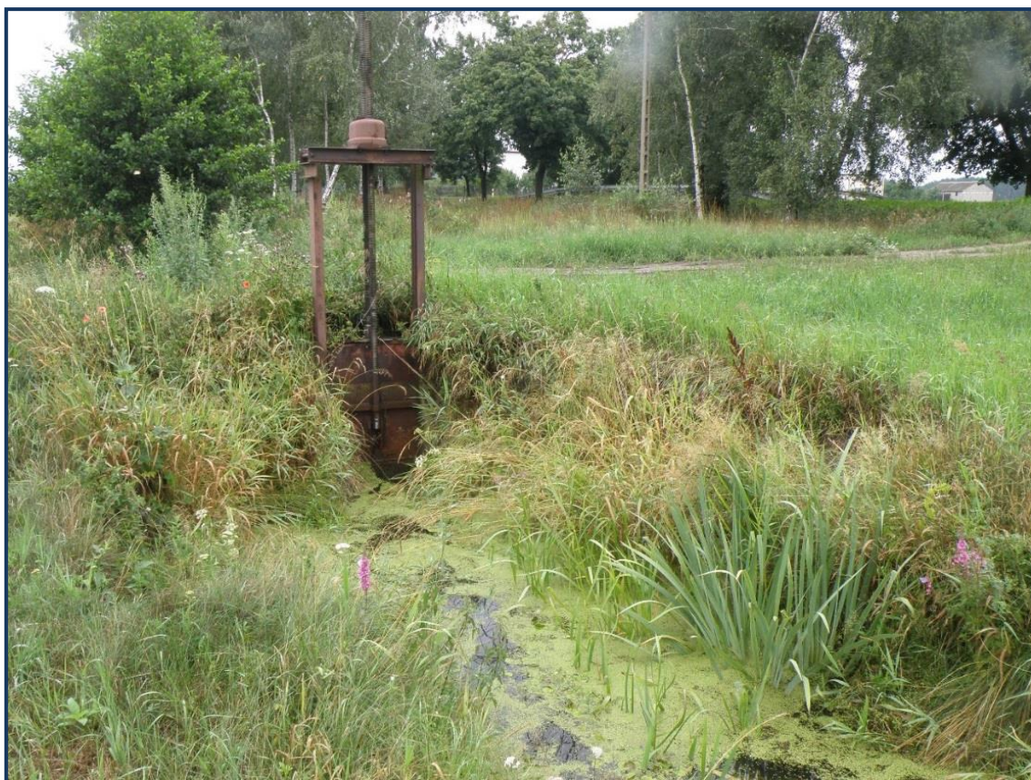
Rycina 13 Zarośnięty rów melioracyjny i przepust z piętrzeniem z przerdzewiałym mechanizmem wyciągowym – Szubin, woj. kujawsko-pomorskie (fot. B. Kierasiński)
